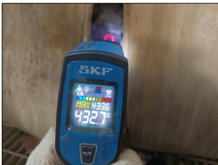
Figura 7 - Medição da temperatura de uma tubulação de vapor sem isolamento térmico.
