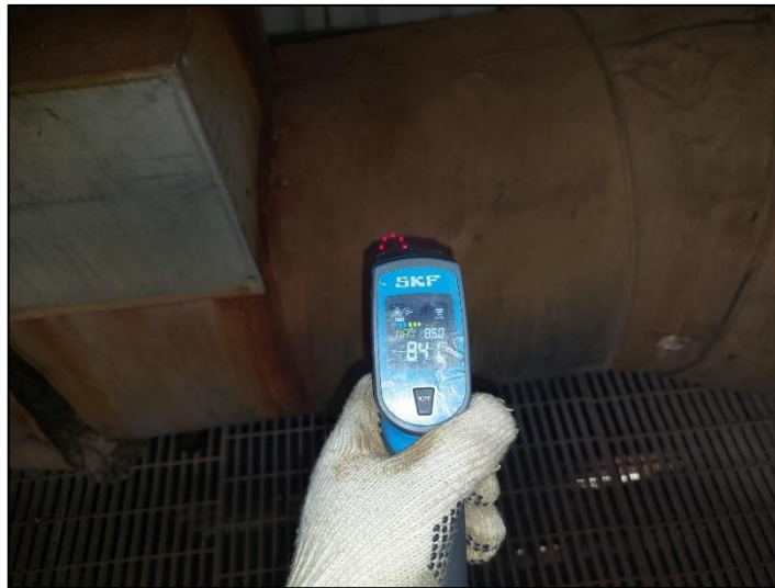
Figura 8 - Medição da temperatura de uma tubulação de vapor com isolamento térmico.
