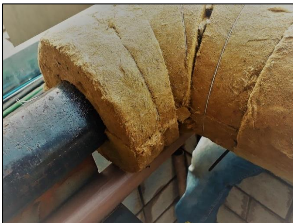
Figura 4 - Aglutinação de isolamento térmico numa tubulação.
