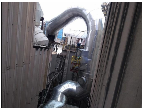
Figura 5 - Revestimento térmico em aço alumínio duto de fuligem.
